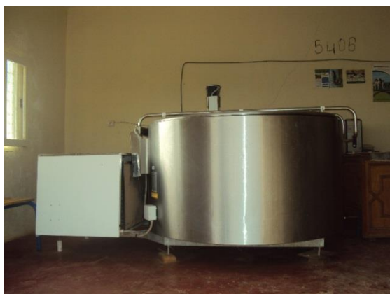
Photo 1. Le bac réfrigérant de la coopérative de collecte de lait
