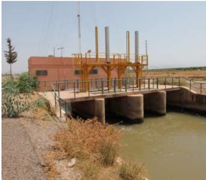
Photo 1. Vannes motorisées sur le canal de Rocade
