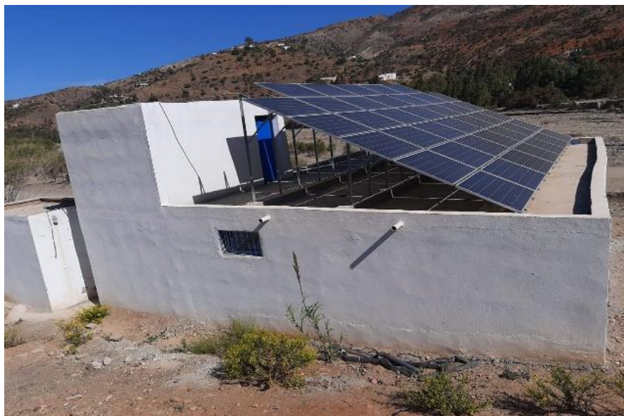
Figure 3. Station de pompage solaire collective gérée par l'association des usagers d'eau agricole "Assakour", située dans le bassin de l'Oued Nekour
