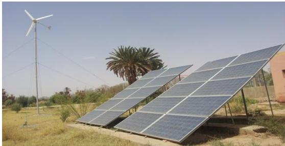
Photo 2. Panneaux solaires dans la coopérative Salmia
