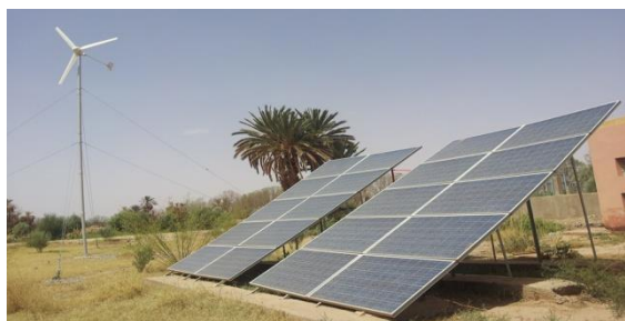
Photo 2. Panneaux solaires dans la coopérative Salmia
