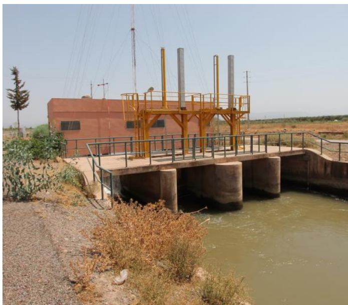
Photo 1. Vannes motorisées sur le canal de Rocade
